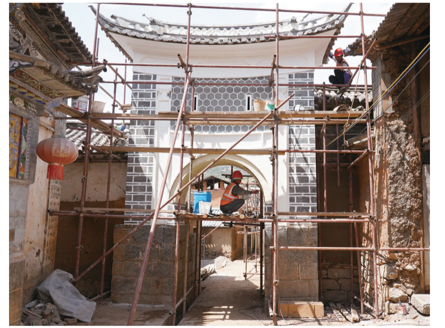
工人对宾川县大营镇茄村传统保护村落古建筑进行加固修复。(摄于5月24日)
