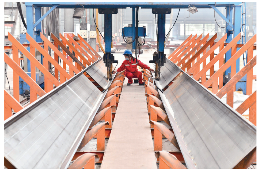
5月28日,在嘉祥县国家级装配式建筑产业园,工人在焊接装配式钢结构框架。山东省济宁市嘉祥县依托建筑和建材产业优势,通过政策引导、产业扶持等措施,培育壮大装配式建筑产业,推进建筑业绿色低碳发展。据悉,2022年嘉祥县装配式建筑产业产值31.75亿元,装配式建筑产业已成为当地促进经济高质量发展的特色产业。 [新华社记者 郭绪雷 摄]
