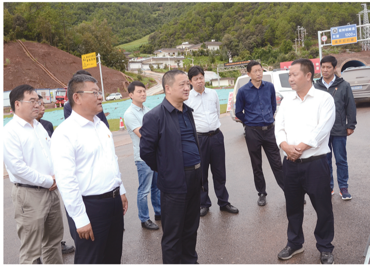
9月7日上午,州委书记杨国宗在云龙县梨树坡隧道施工现场实地调研项目建设情况。
