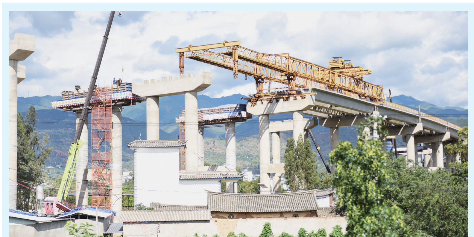
7月25日,工人在架设大南(大理至南涧)高速公路巍山段兴禾厂大桥。大南高速公路系国家高速公路网大临高速公路的重要组成部分,是云南省“五纵五横一边两环二十联”高速公路网中第四纵,全长91.509千米,概算总投资168.8996亿元。大南高速公路巍山段全长59.255公里,估算总投资109.0292亿元,目前已完成投资50.55亿元。
