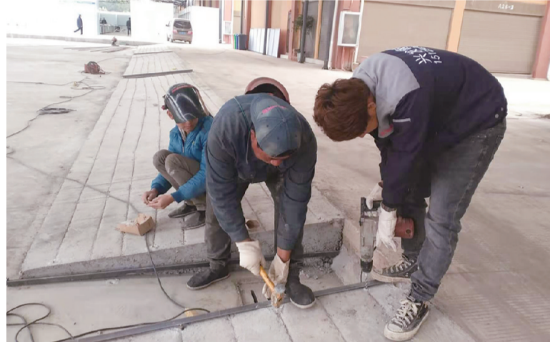
2020年12月21日，工人师傅正在抓紧宾川县新嘉源农产品交易中心项目建设。宾川县新嘉源农产品交易中心位于大和新嘉源商贸城南面，占地面积约10亩，项目总投资361万元，主体工程为钢结构。新嘉源农产品交易中心的建设，将为宾川农产品交易带来良好的交易平台。 [通讯员 张兴祥 摄]
