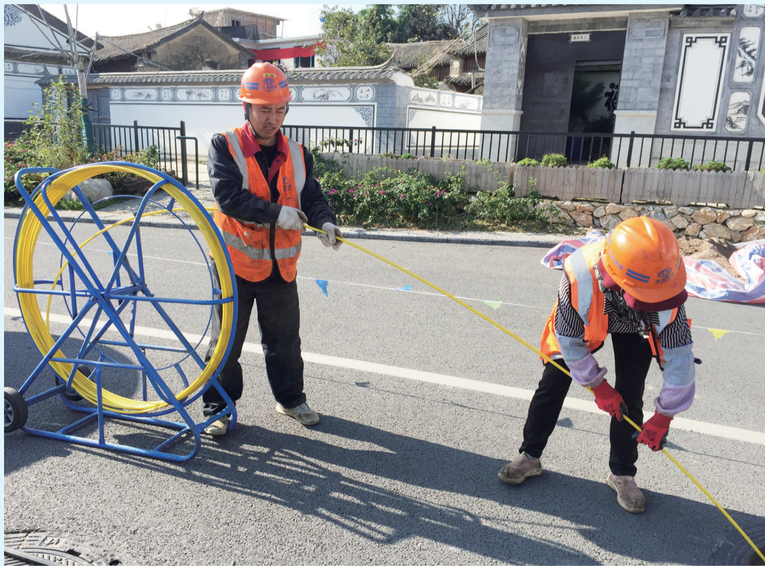
11月13日,施工人员在洱海生态廊道进行地下电缆的施工。 在洱海生态廊道建设指挥部的统一协调指挥下,云建投总承包二部、大理苍洱投资建设有限责任公司等洱海生态廊道承建单位和设计单位通力合作,在保证工程质量和施工安全的前提下,统筹好各方力量,细化作战方案,加快项目推进,全力以赴确保高标准高质量按时完成129公里洱海生态廊道建设。 [记者 辛向东 摄]
