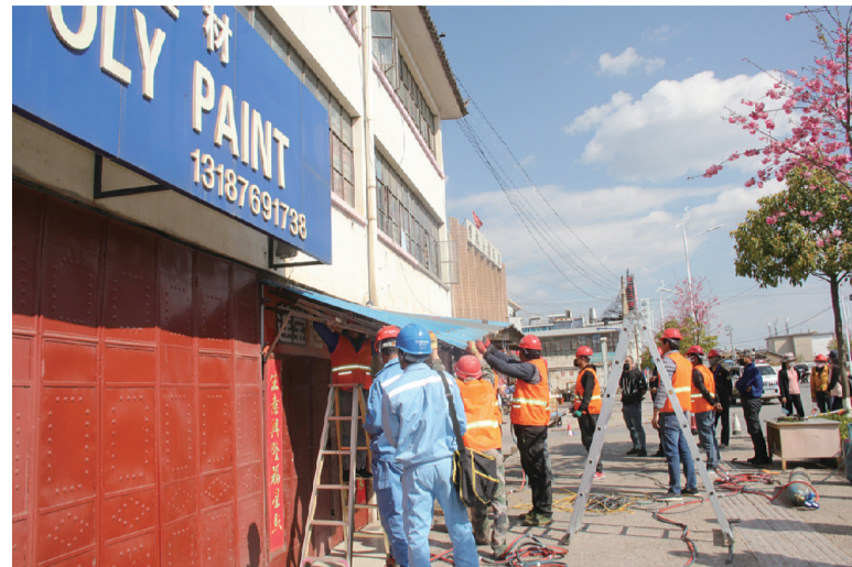
3月12日,工作人员正在鹤庆县城东环路依法拆除彩钢瓦雨棚。
