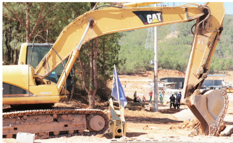
3月14日上午,鹤庆县坝区石材加工户搬迁安置项目施工现场。该项目是鹤庆县为解决石材加工户分散加工容易造成环境污染等问题而开展的集中搬迁安置项目,当前项目基础建设工程正在推进当中,预计6月底可完成一期工程。
